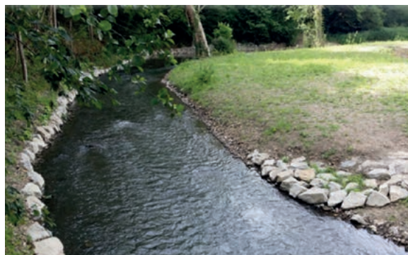
La berge rive droite en aval de l'ancien seuil OH17a confortée par enrochement, en juin 2015.
