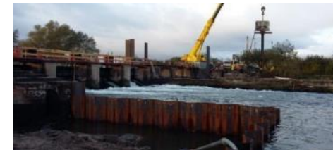
Restauration en cours du barrage de la Steinsau : protection contre les crues, passe à poissons, canoë, hydroélectricité
