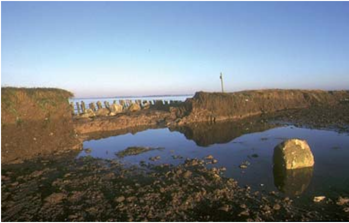
Rupture au Marais de Moëze
